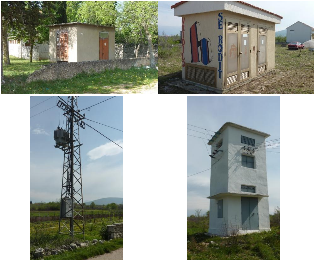
Slika 2: Primjer trafostanica (mjernih mjesta) na području Općine Promina
